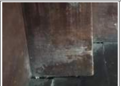
PRESENCIA DE HUMEDAD EN EL ZÓCALO A-08
