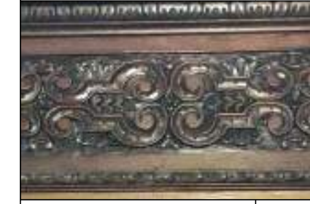
MANCHAS NEGRAS EN ORNAMENTO DE MADERA POR HONGOS
