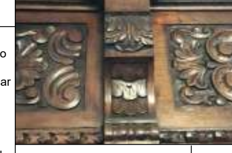
MANCHAS NEGRAS EN ORNAMENTO DE MADERA POR HUMEDAD
