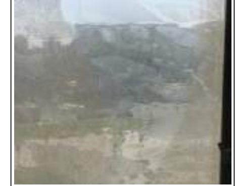
VIDRIO CON PROTECTOR INADECUADO A-04
