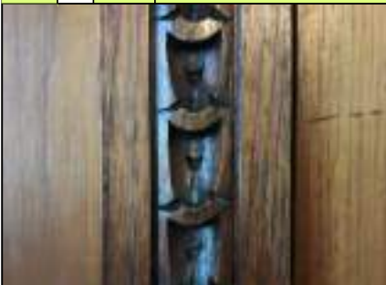
DETALLE DE ORNAMENTO VERTICAL Y GRIETAS
