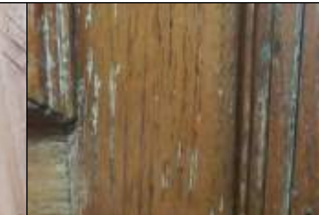
PRESENCIA DE GRIETAS POR DILATACIÓN DE MADERA
