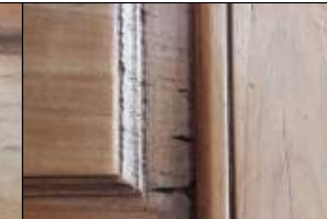
FISURAS PRESENTES EN ORNAMENTO HUNDIDO
