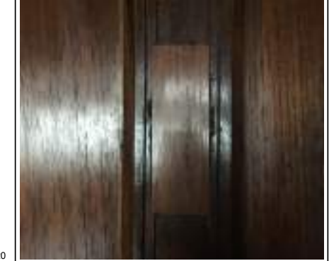
PÉRDIDA VOLUMÉTRICA A-02
