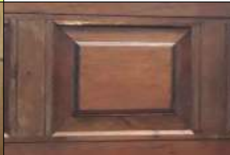
SUCIEDAD POR DEPÓSITO EN RELIEVES
